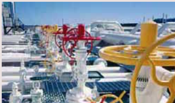
▲ Figura 10.15 Estación de rebombeo de gas natural.
