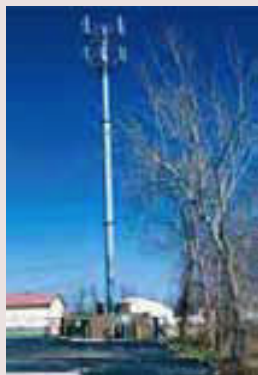
◀ Figura 12.29 Torre para comunicaciones inalámbricas.
